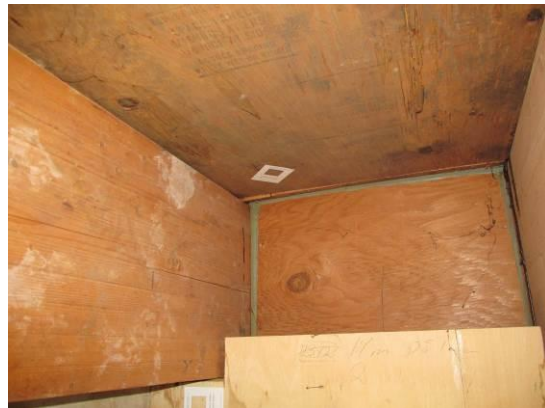
#2 Tagrum over venteværelse – der er ikke synlig skimmelvækst.
