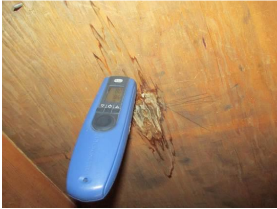
#3 Tagkrydsfiner er tør (8 % træfugt). Prøve P/T1 er udtaget på fugtskjold, og er således udtaget hvor fugtpåvirkning forventes at have været højest. Prøve P2 er udtaget på overside af nedstroppet loft.
