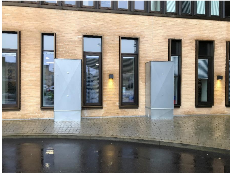
Figur 1. Indtag (venstre) og afkast (højre) på facade ved akutcentrets hovedindgang.
