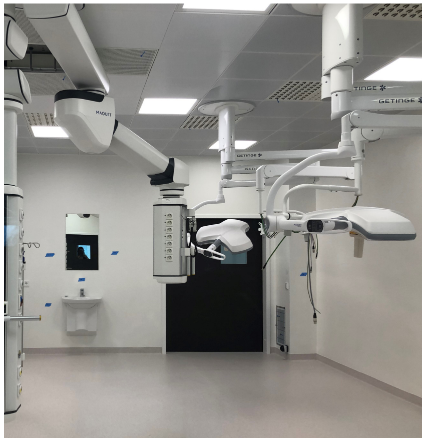
Figur 6: Operationsstue på Regionshospitalet Gødstrup med indblæsning af ultraren luft over lejet, hvirveldiffusorer uden for lejeområdet samt udsugning ved gulv.
