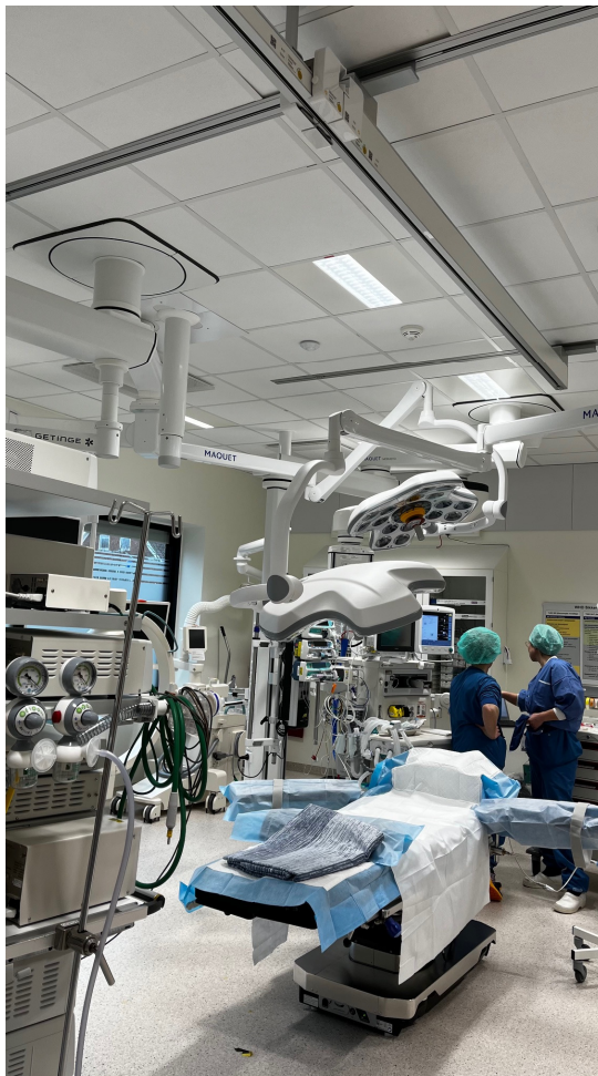
Figur 3: Loftlift er her placeret over OP-lejet i hensigtsmæssigt samspil med det øvrige lofthængte inventar.
