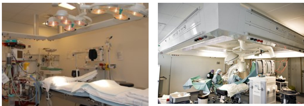
Loftmonteret bro, hhv. Hospitalsenheden Midt og Glostrup hospital
