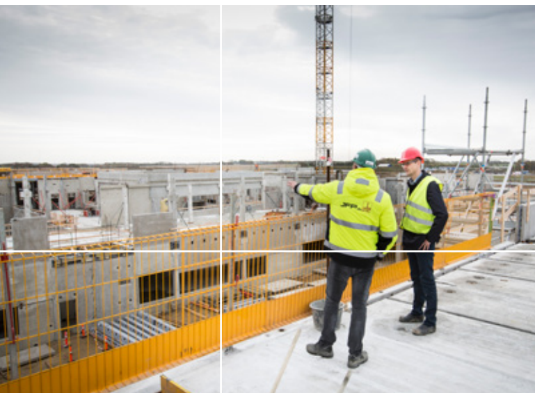
DNV Gødstrup er nu mere end halvvejs og er skudt tre etager op i højden
