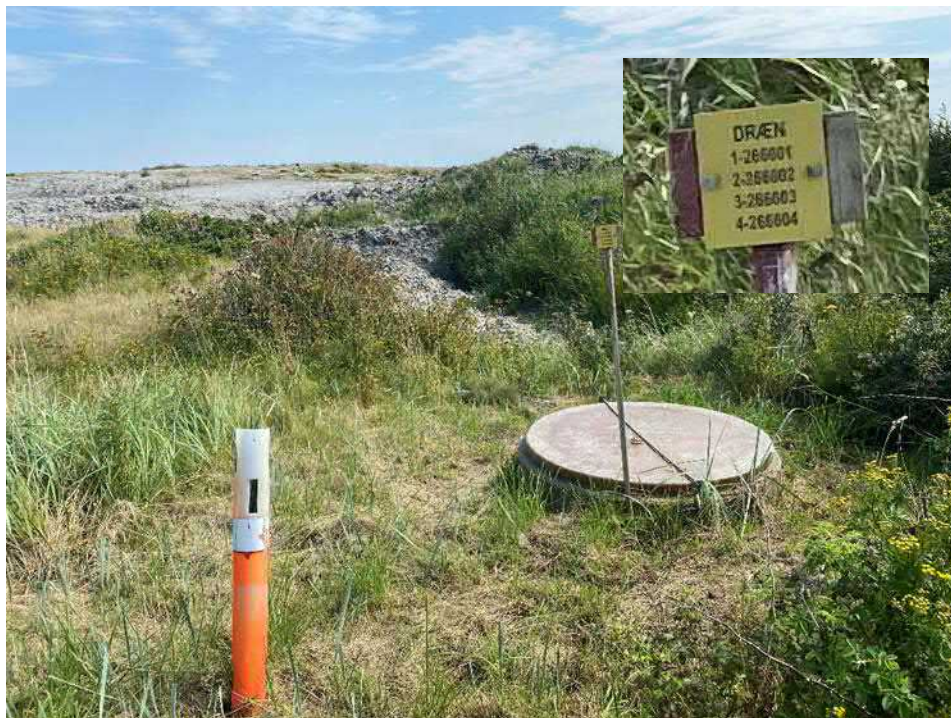
Figur 3.10. Lokalisering af pumpebrønd og nummerering af dræn.
