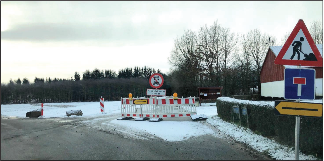
Figur 13. Funder Skolevej ved krydset med Nørhedevej, set mod syd. Vejen var spærret på tidspunktet for besigtigelsen med omkørsel via Nørhedevej.
