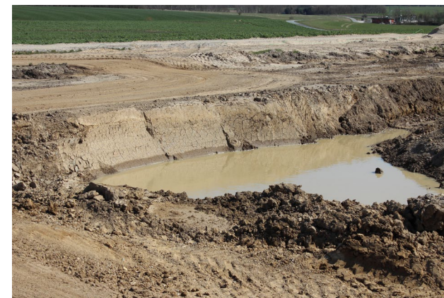
Figur 11.3 Eksempel på hvordan overfladevand stopper ved gravefront, her fra den eksisterende indvinding nord for Langvadvej. (LE34, 2021)
