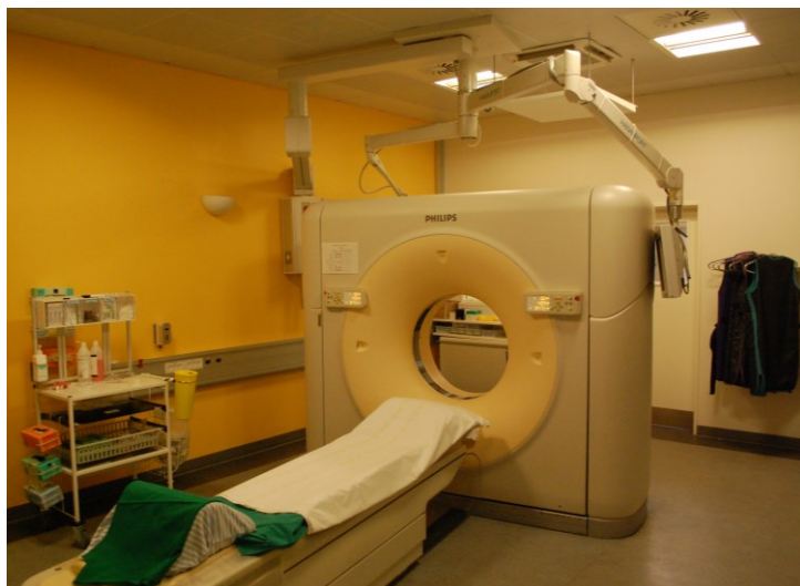
Figur 7: eksempel på CT-scannerrum med sprøjtepumpe, skærm og udtag til ilt og sug placeret på mobile arme i loft, så de er tilgængelige fra begge sider af gantry, Aarhus Universitetshospital.
